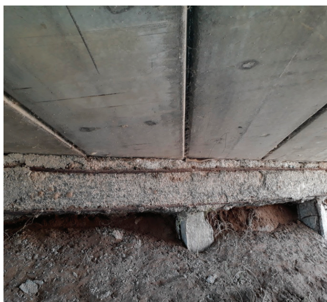
Рис. 2. Дефекты конструкций опор по причине солевой агрессии
